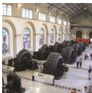
Centrale di Malniso – ERIH Anchor Point
